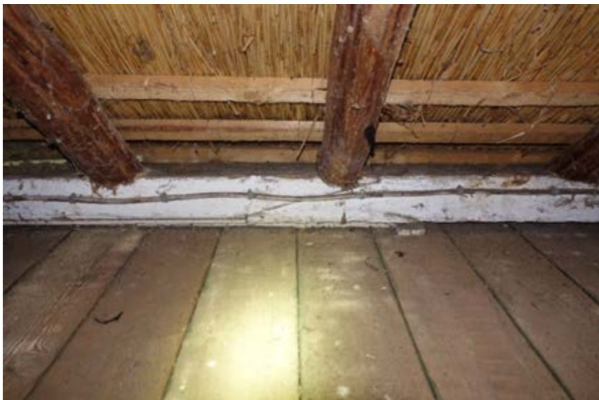
Schuine liplas in de muurplaat boven de linker zijgevel.
