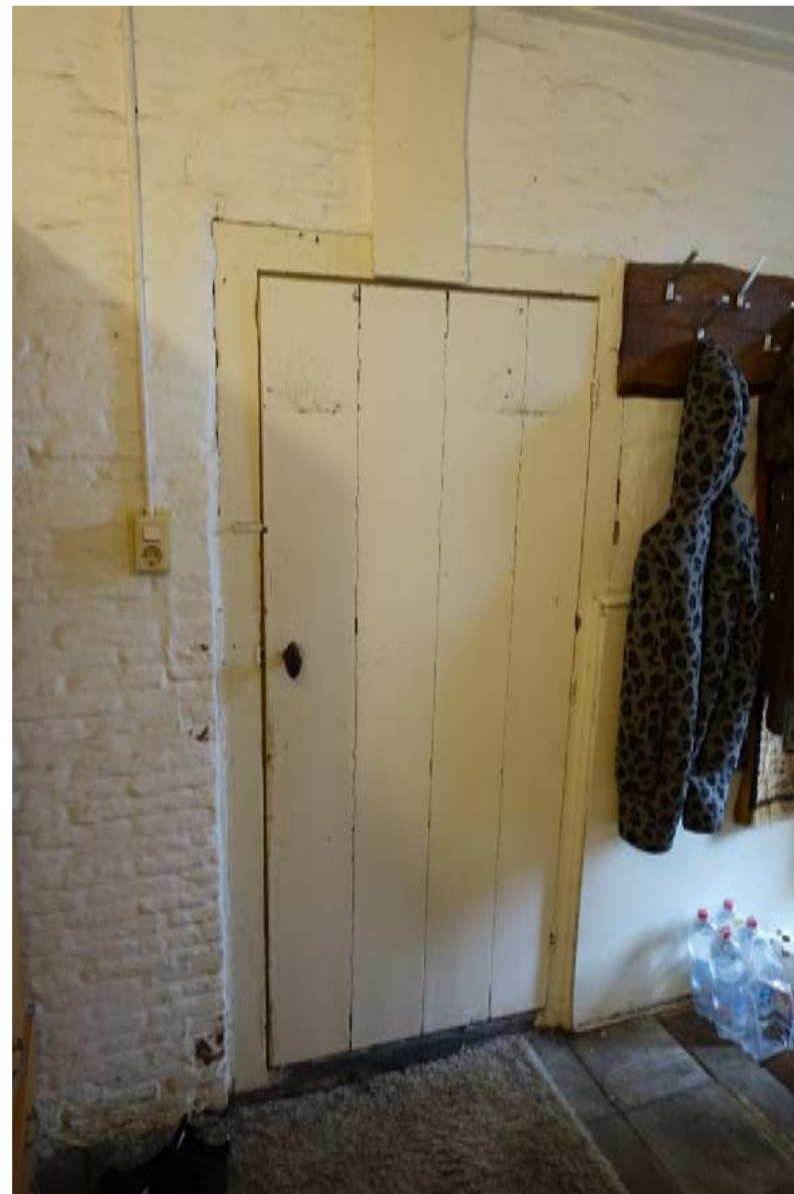
Links van- en boven het kozijn is het metselwerk wat onregelmatig.
