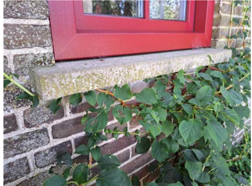
Afwijkend metselwerk onder venster in de voorgevel.
