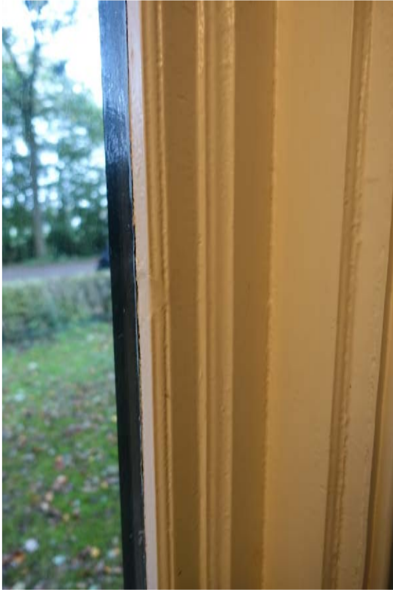
Op het raamhout tekenen de verwijderde roeden zich nog af.
