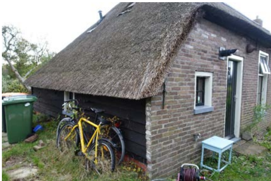
Overzicht van de achtergevel. Het hier aanwezige venster heeft een niet-bijpassende detaillering met een kozijn met luikspinning.
