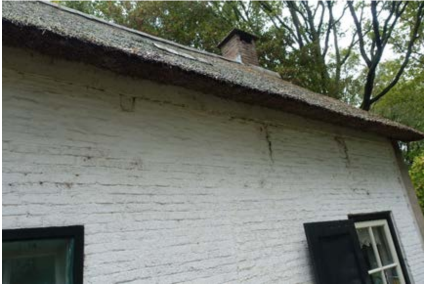
De bovenstrook van het metselwerk is vertind, terwijl het deel daaronder is geschilderd.
